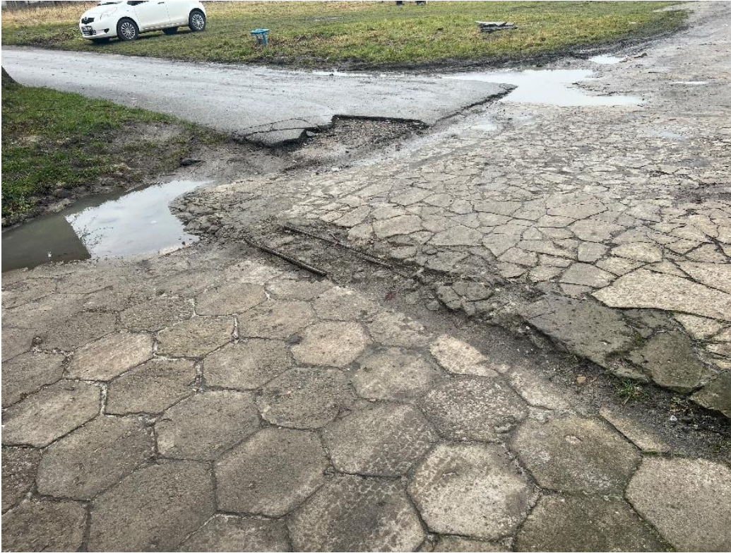
Zdjęcie 13. Ul. Chełmska – zły stan techniczny ciągów pieszo-jezdnych i placów, bariery architektoniczne.
